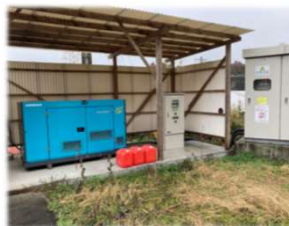
非常用発電設備
