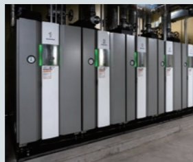
LPガスボイラー
