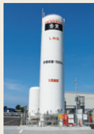
ボイラー設備の燃料を CO 2 排出量が少ないLNG （液化天然ガス）に切り替え
