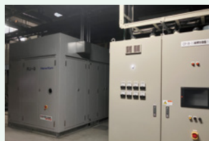
三重工場の自然冷媒冷凍機
