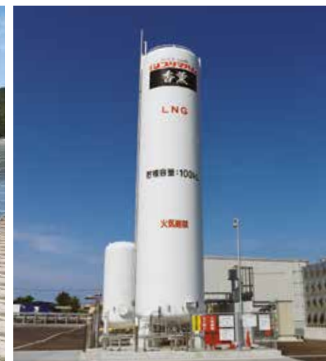
ボイラー設備の燃料をCO 2 排出量が少ないLNG(液化天然ガス)に切り替え
