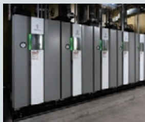
LPガスボイラー
